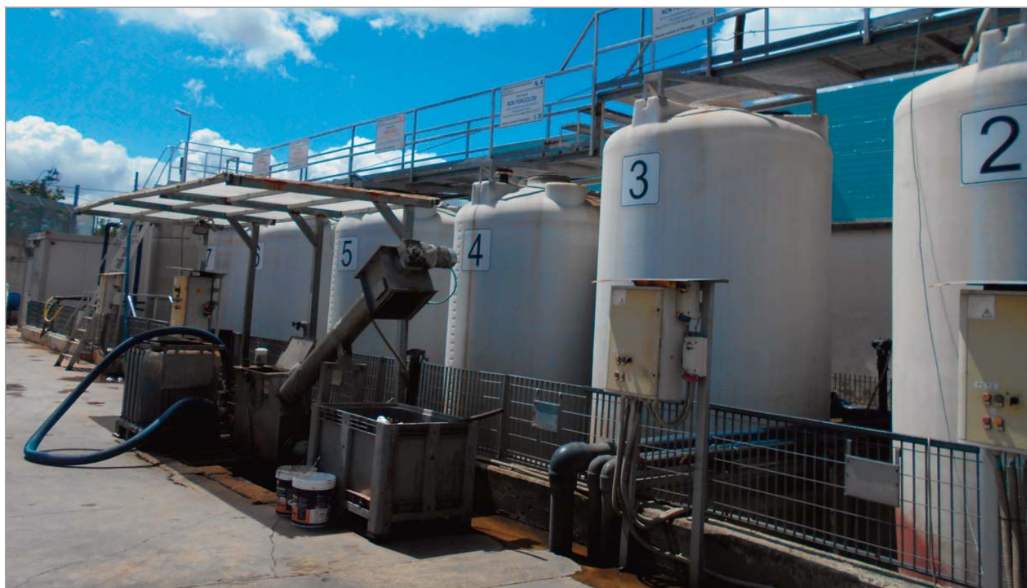
Impianto di recupero rifiuti liquidi (distillazione e ozonizzazione)
