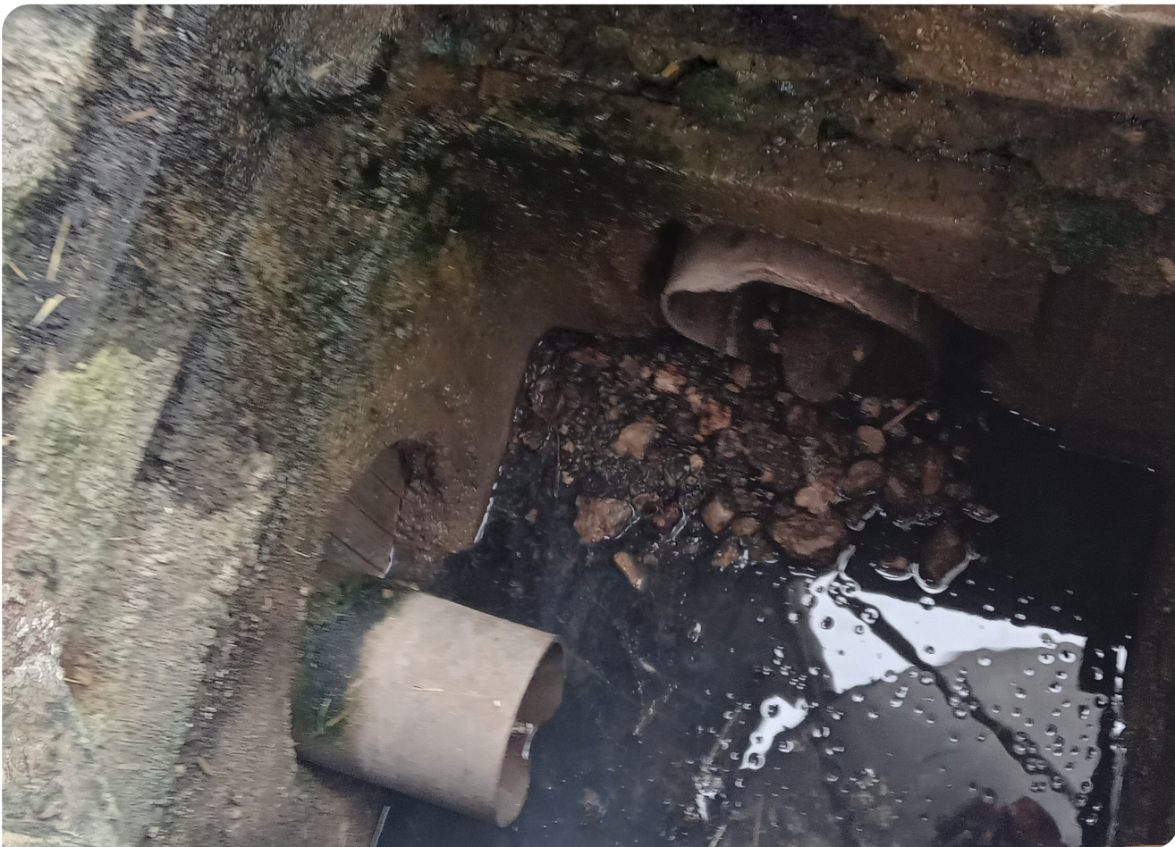
Foto 3 Immissione illecita di effluenti zootecnici nel ricettore mediante tubazione sottotraccia (fonte : Area Territoriale ARPAC Caserta)
