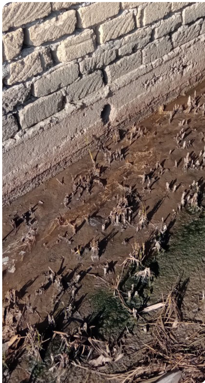
Foto 2 Immissione illecita di effluenti zootecnici nel ricettore mediante fori realizzati all'uopo nelle pareti delle vasche di raccolta (fonte: Area Territoriale ARPAC Caserta)
